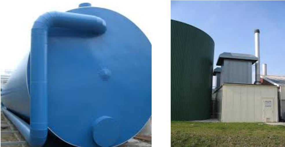
Fig. 91 Een liggende (links) en een staande (rechts) warmwateropslagtank.
